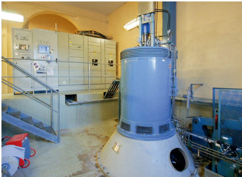
Ryssa övre av idag, generatorn närmast i bild. Foto: Ola Måspers
