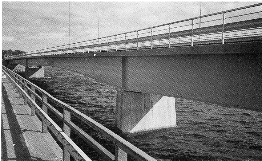
I början av september stod den nya bron klar. Brobalkarna målades i en ljus blå färg som stämde väl mot vatten och himmel. Bron är indelad i tre spann, har en längd av 197 meter och en segelfri höjd på 5 meter.
